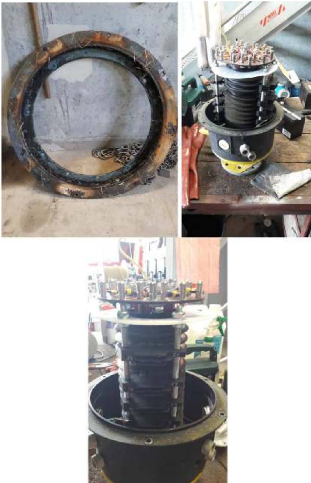
Chemin de billes usé (roulements HS) Collecteur avant réparation Collecteur après réparation
